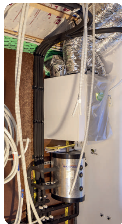
Sistema de Ventilación de la vivienda
